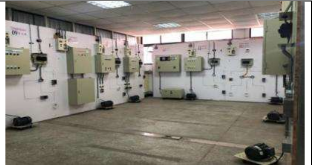
室內配線教室
